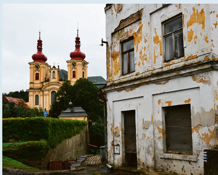
Während die Wallfahrtsbasilika auch im Regen wieder in altem Glanz strahlt, wurde dieses Haus in direkter Nachbarschaft noch nicht saniert.
